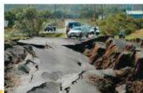
Εικόνα 16.2: Καταστροφή από σεισμό
